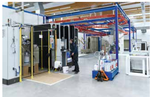
Die modernen Lackieranlagen können als Entscheidungshilfe vor Investitionen besichtigt werden.
